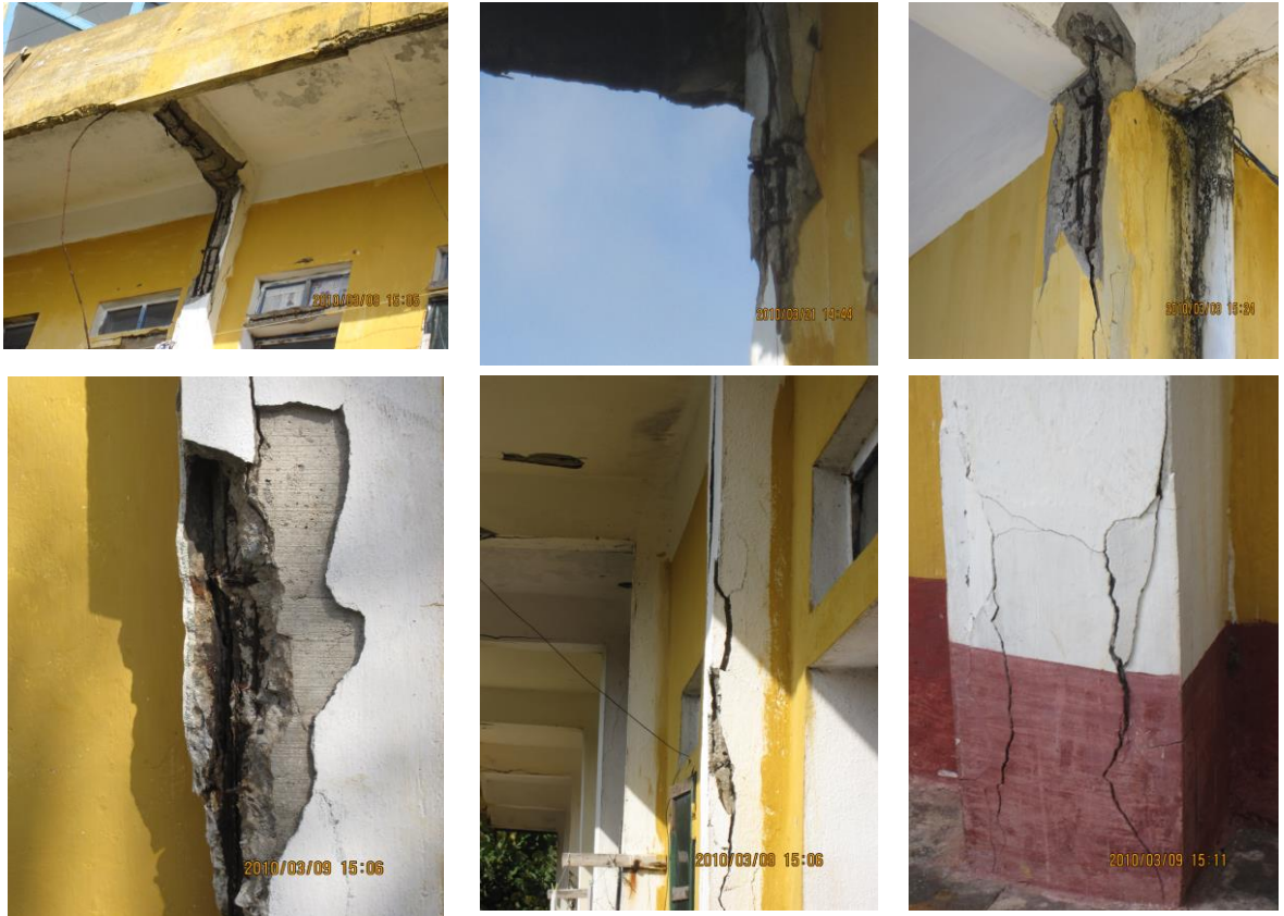
Hình 2. Các vết nứt tại nhà chỉ huy bay trên đảo Trường Sa Lớn năm 2010 (công trình được xây dựng năm 1995-1996)
